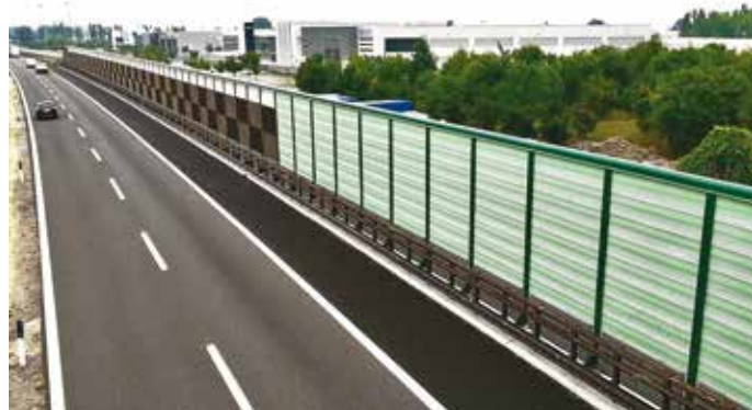
6. Un particolare delle barriere di sicurezza integrate in acciaio Cor-Ten
