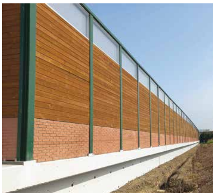
2. Un dettaglio delle barriere fonoassorbenti in policarbonato, legno e muretto in c.a.
