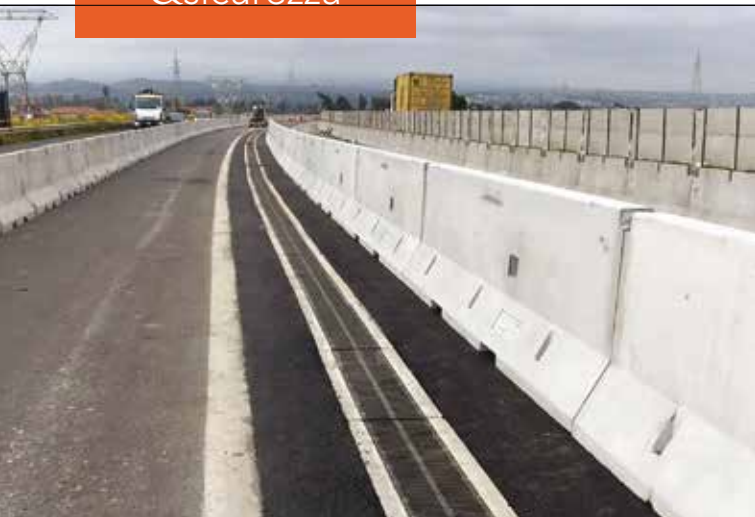
5. La barriera NDBA spartitraffico posata, completa di canaletta per la raccolta delle acque di piattaforma
